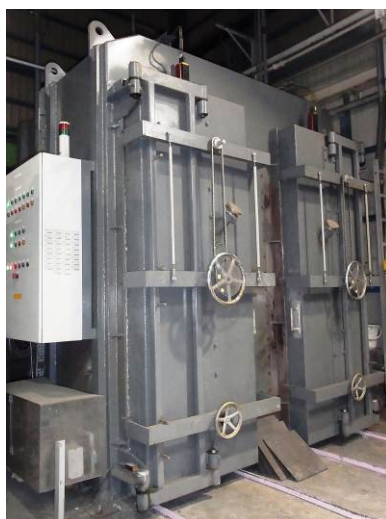
シアン化合物を分解処理する炉の外観
